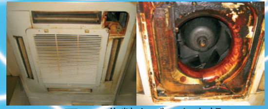
エアコン化粧カバーと内部
